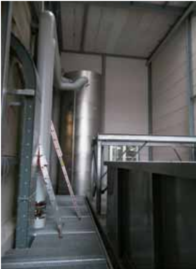
Der Wärmespeicher wird über die Wärmepumpenanlage auf 65 °C. aufgeheizt
