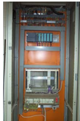
Umbauphase 2 Ersatz der kompletten Peripherieanschaltung für 1600 I/O's mit ET200M
