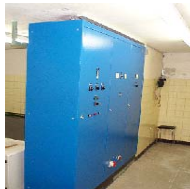
Schaltschrank-Lieferung mit dem Helikopter wegen des Jahrhundert-Schnees
