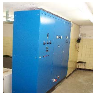
Schaltschrank-Lieferung mit dem Helikopter wegen des Jahrhundert-Schnees
